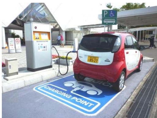
図2. 海老名サービスエリアに設置された急速充電器
