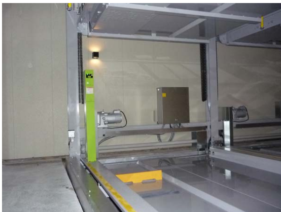
機械式駐車場
